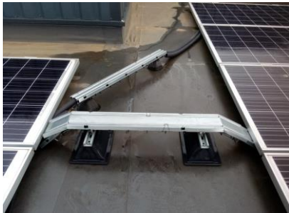
Plot + chemin de câble entre champ PV
